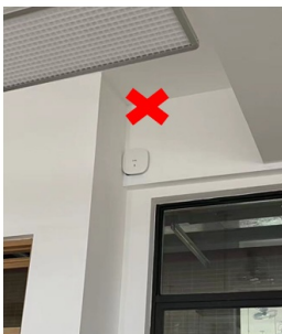
AP被安装在墙体拐角处，遮挡严重，信号衰减大
